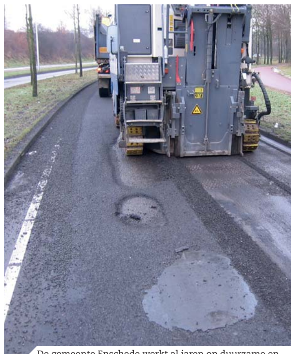
De gemeente Enschede werkt al jaren op duurzame en milieuverantwoorde wijze aan de verwijdering van teerhoudend asfalt uit de wegen in haar openbare ruimte.
